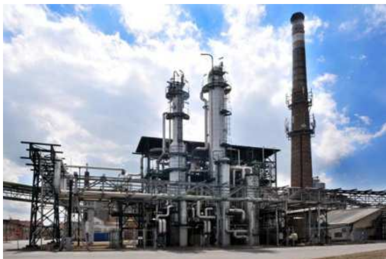
Obr. 4 (Destilační jednotka pracující v lihovaru VRDY)
