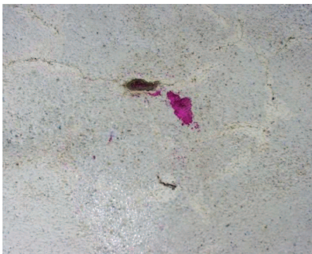
Obr. 5 - Kostel v Lukovanech – důkaz nezkabornatovaného vápna pod cementovou krustou pomocí fenolftaleinu (foto P. Rovnaníková)
