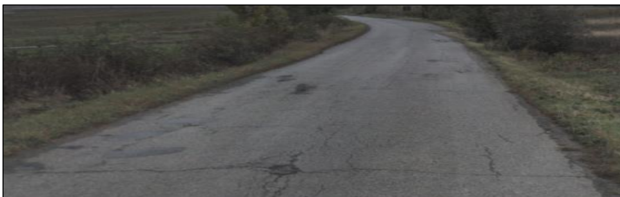
Obr. č. 35 – Ukázka poruch vozovky úseku realizace jízdních zkoušek [vlastní]
