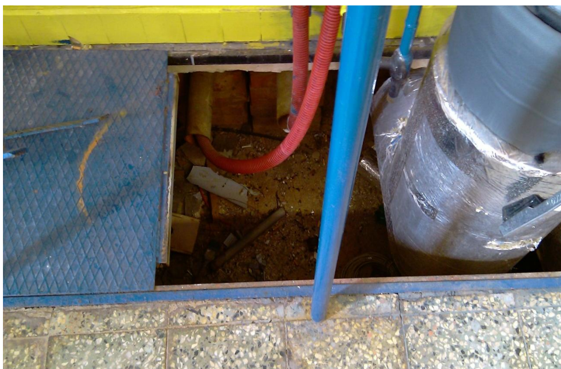
Snímek č. 10: Vyvedení opt. kabelu v prostorách VS2
