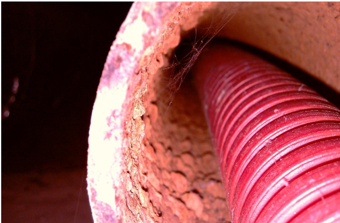
Snímek č. 7: Rozříznuté potrubí – detail inkrust
