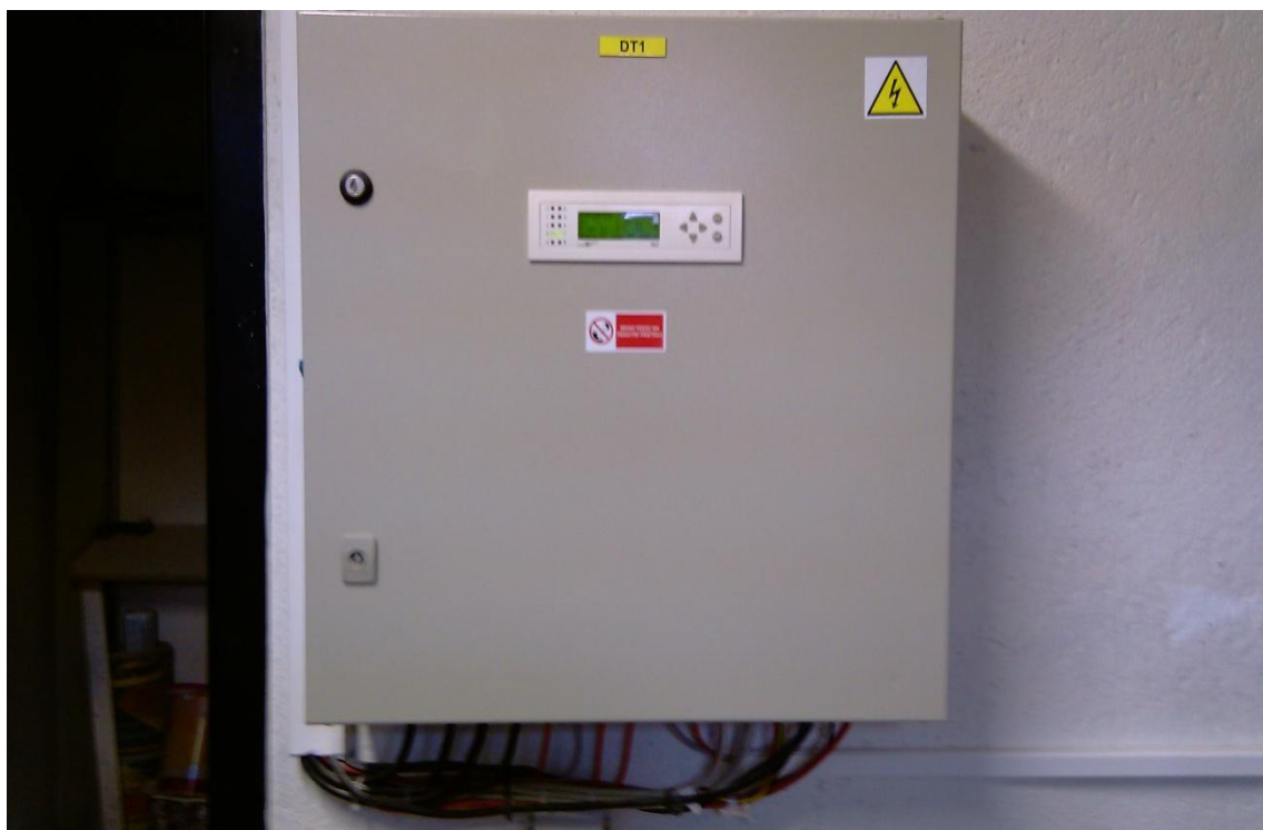
Snímek č. 9: Koncový rozvaděč v DPS
