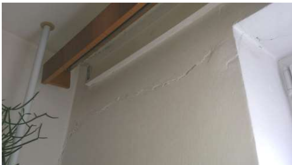
Obr. č. 34- Trhlina u okenního překlady. [archiv autora DP]
