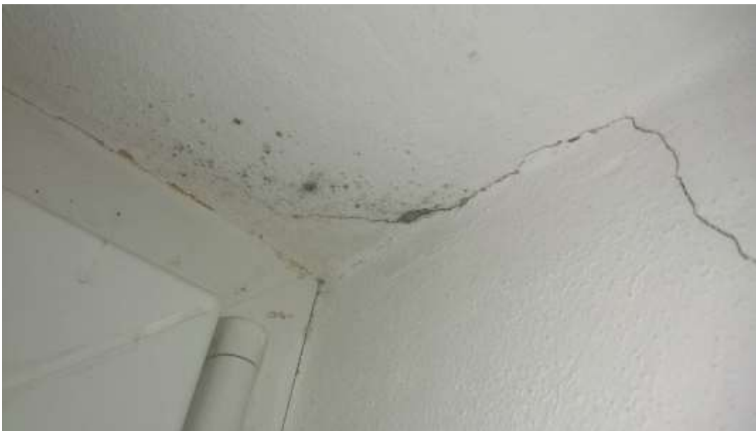
Obr. č. 35- Trhlina a prorůstající plíseň u okna. [archiv autora DP]
