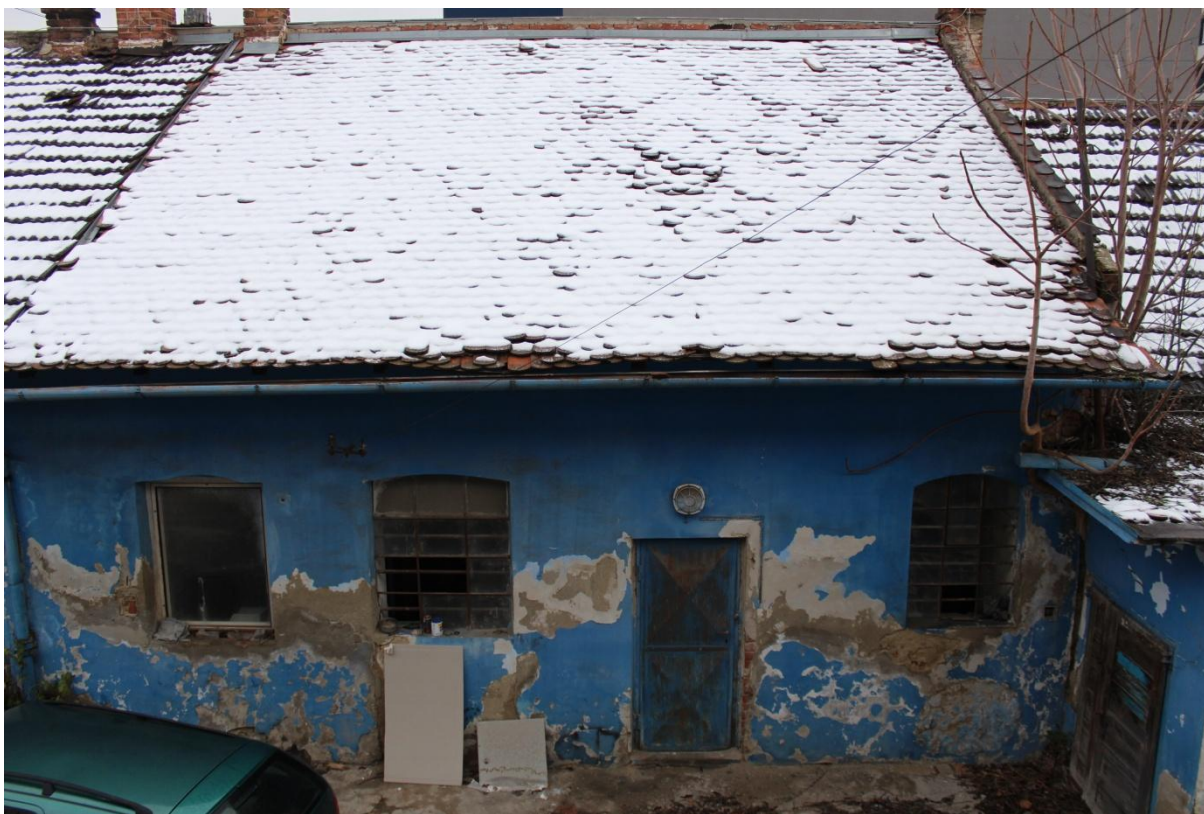
Obr. č. 23 - Špatný technický stav provozovny
