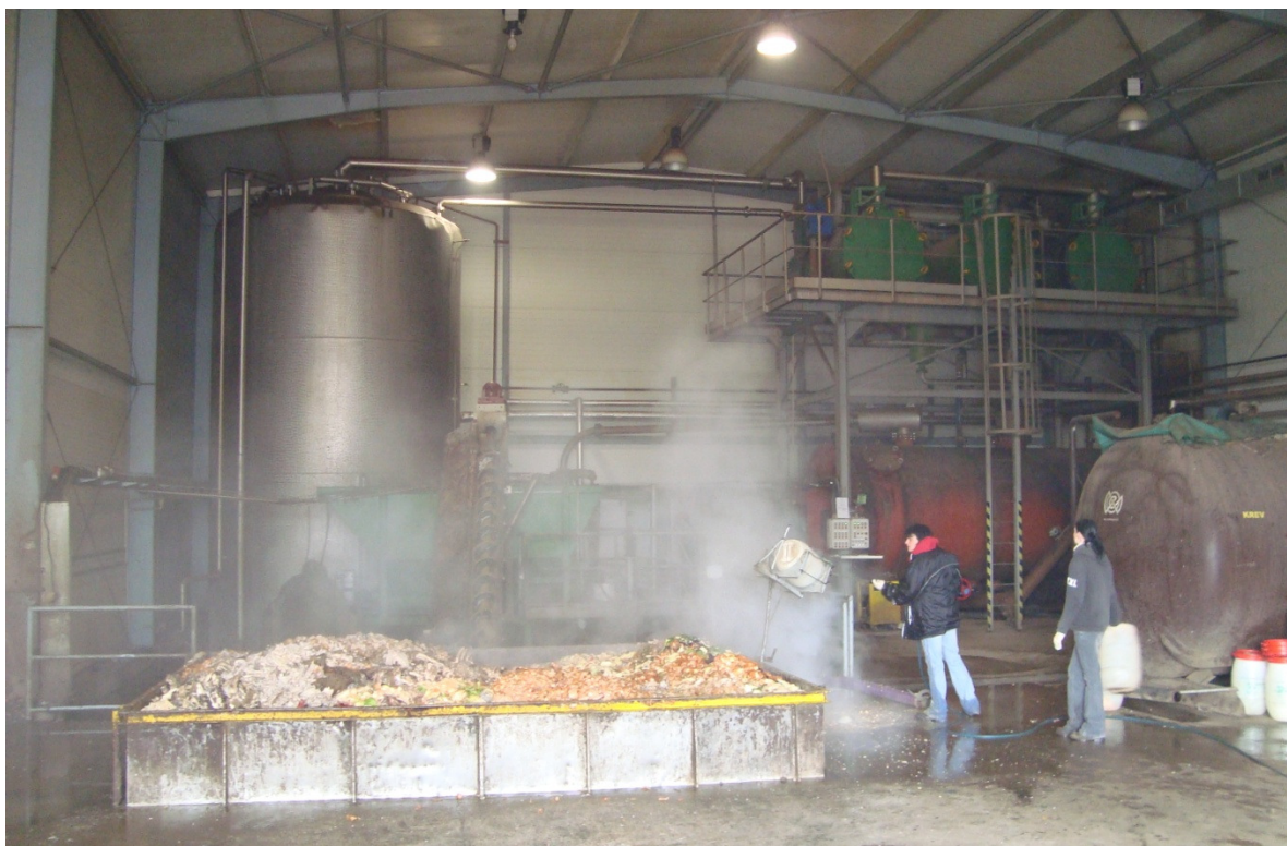
Obr. 11 Hygienizační linka bioplynové stanice Velký Karlov
