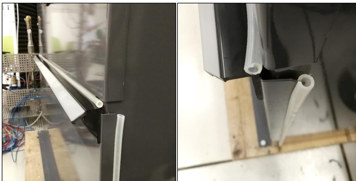
Obr. 30: Zatěsnění prostoru mezi servisními dvířky a pláštěm sušiče, pro zvýšení podtlaku před ventilátorem a omezení přisávání vzduchu z okolí
