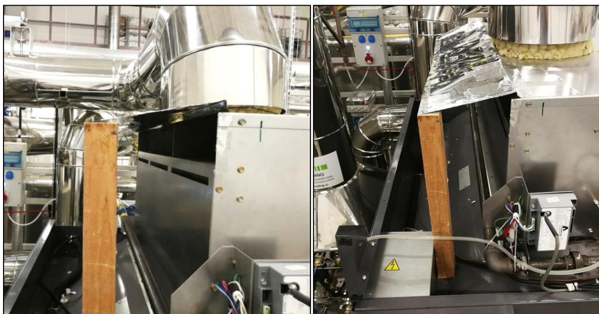
Obr. 26: Provizorní klapka na sání spalovací komory sušiče
