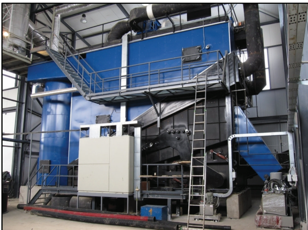
Obrázek 3.2 Technologická jednotka Vesko-B, město Detva (SR) (Reference, 2012)
