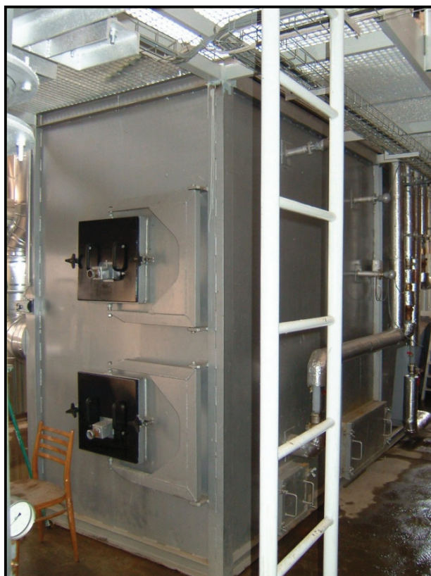
Obrázek 3.6. Spalovací komora testovací jednotky s výkonem 1MW, Kojetín (ČR) (Štulíř, 2008)
