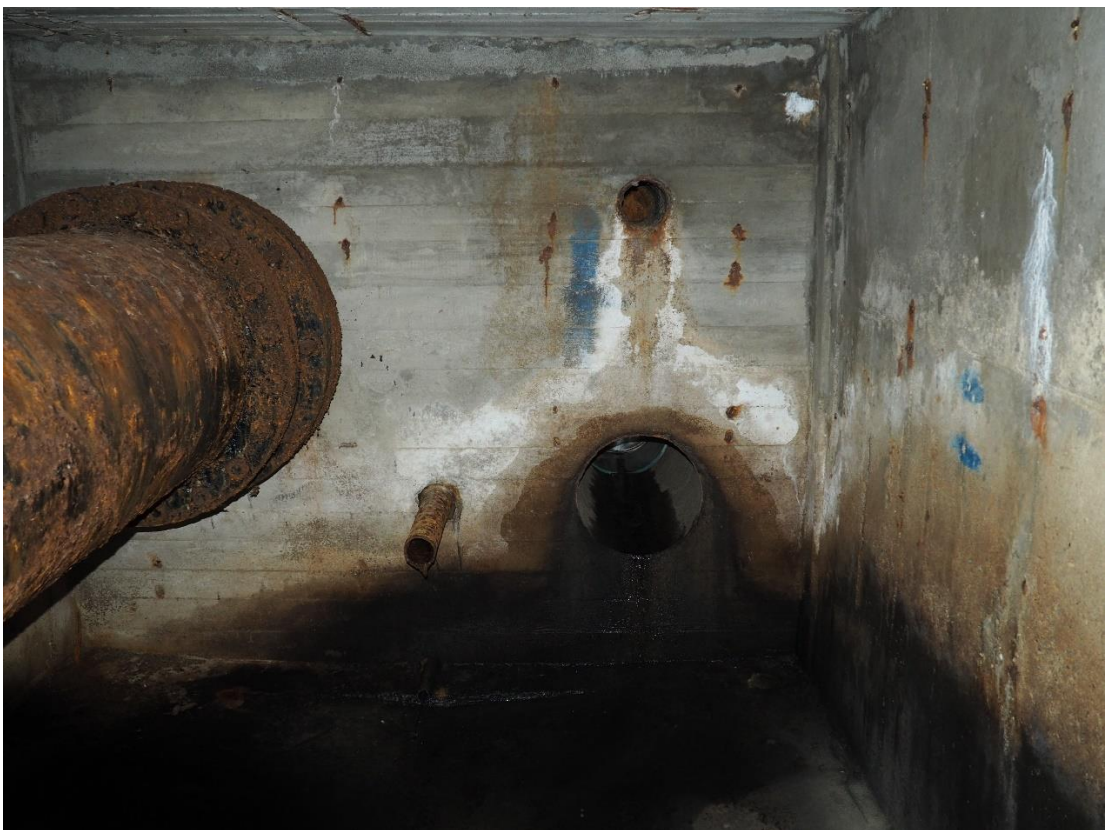
Obrázek 2 - Vyústění DN400 a DN100 do chodby spodních výpustí [8]
