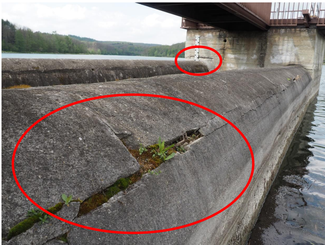
Obrázek 4 - Poškození přelivné hrany [8]
