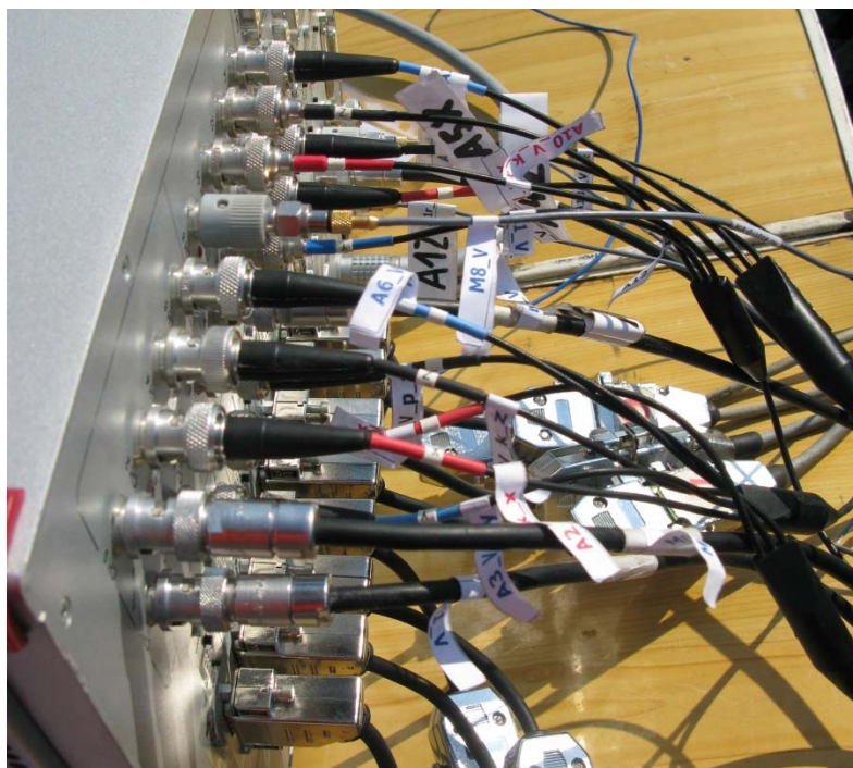
Obr. 5. 3 Zapojení kabelů do měřicí stanice
