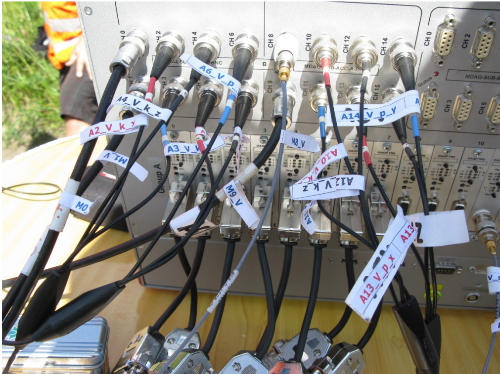
Obr. A. 8 Detail zapojení kabelů do měřicí stanice
