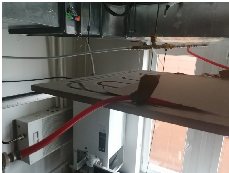
Obrázek D1.1: Pohled na stropní panel shora
