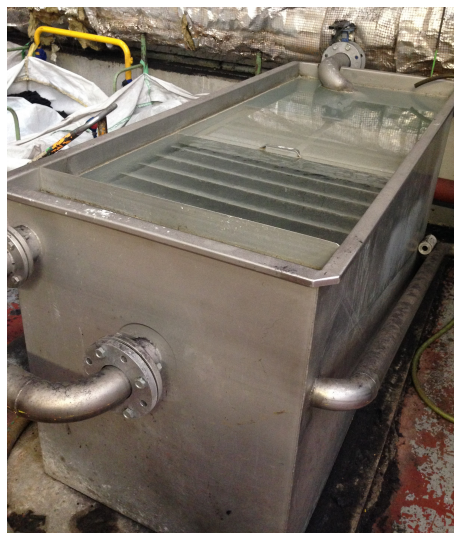
Obr. 3.3: Nádrž na zbytkovou vodu
