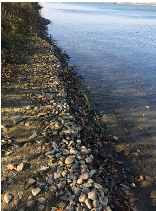
Obr. 19 Stávající stav břehu nádrže
