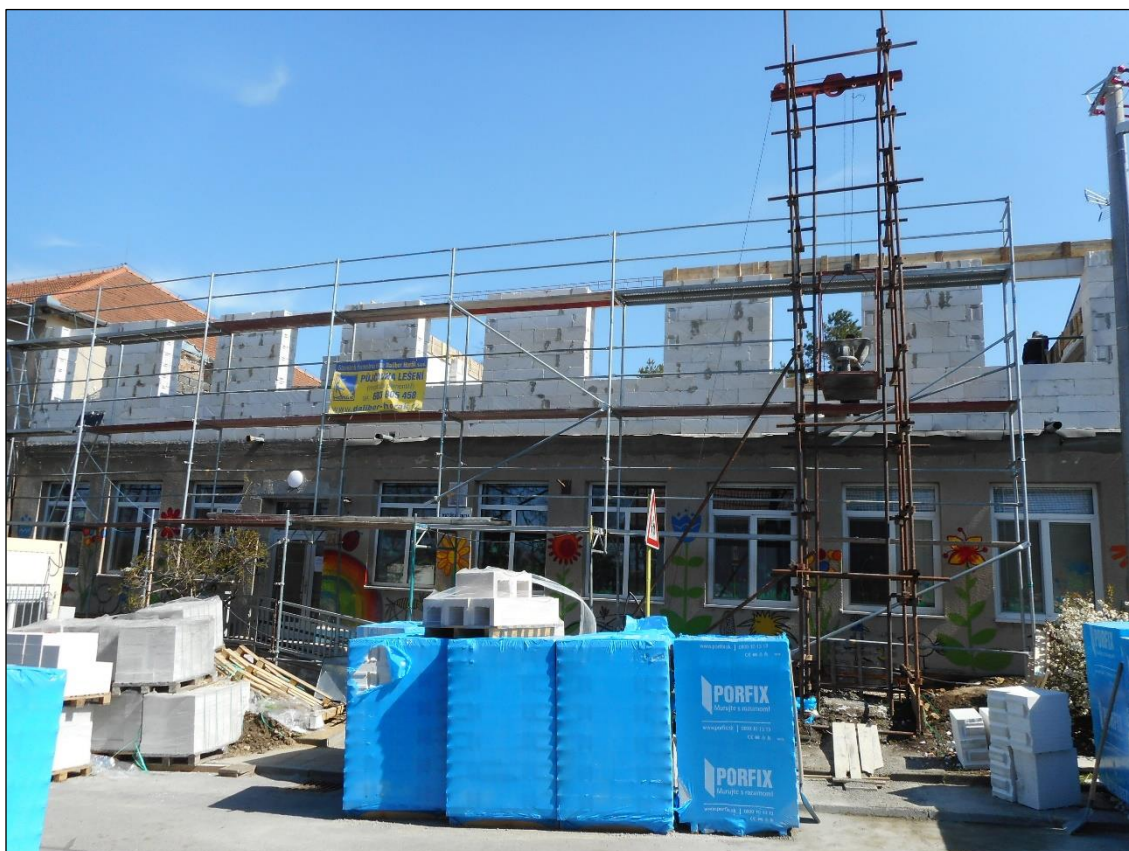
Obr. č. 26 Pokročilá fáze nástavby 2NP, výstavba obvodového zdiva – uliční pohled [vlastní]
