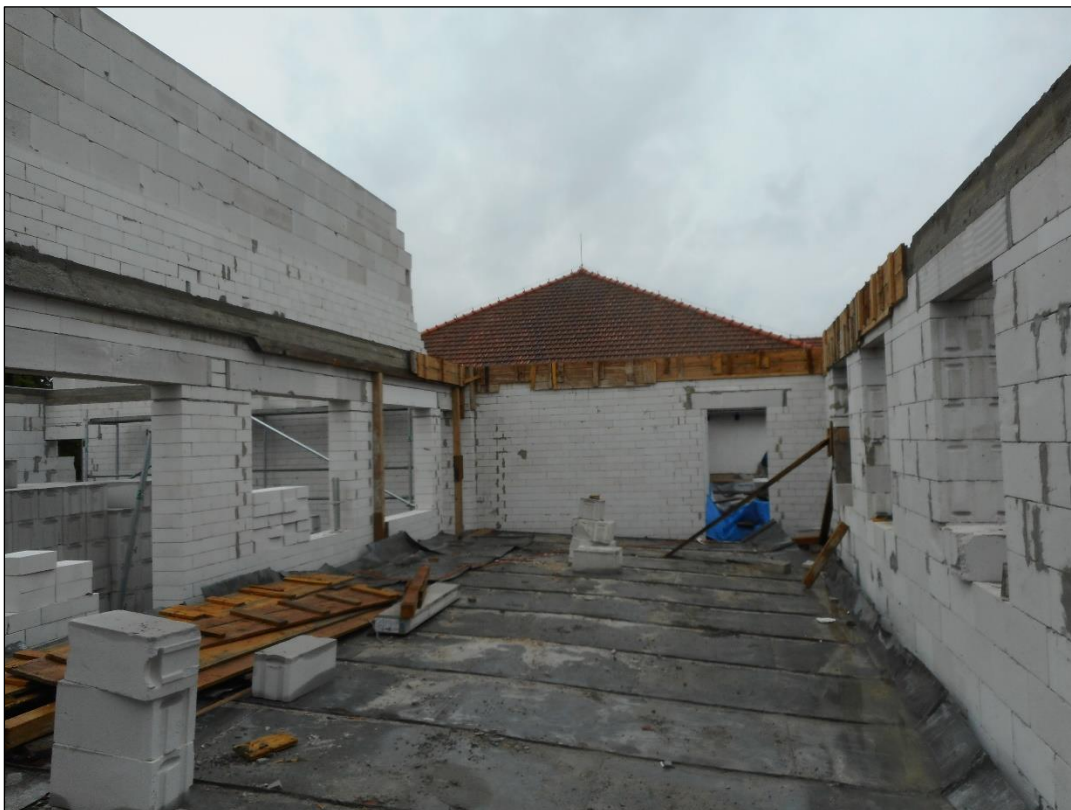
Obr. č. 27 Pokročilá fáze výstavby nosného zdiva 2NP – pohled ze stavby [vlastní]
