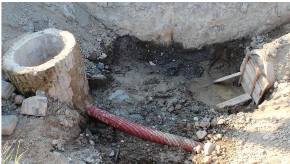
Obr. 18 Potrubí Lichovského potoka [10]
