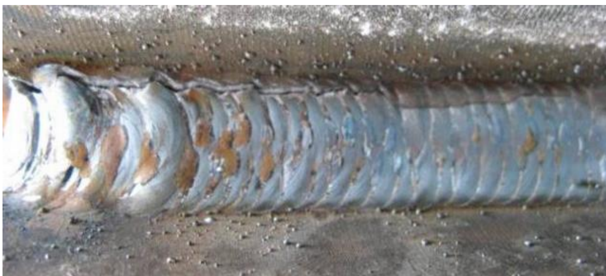
Obr. 10 Ukázka trhliny za studena
