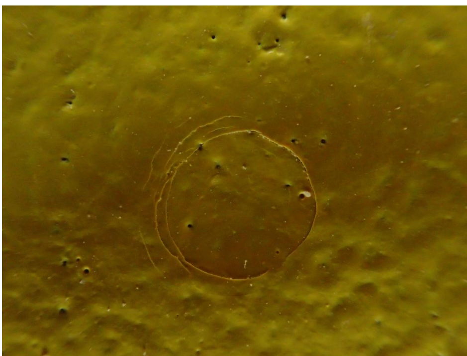
Obrázek 58: Detail porušení nátěru po obvodu otisku
