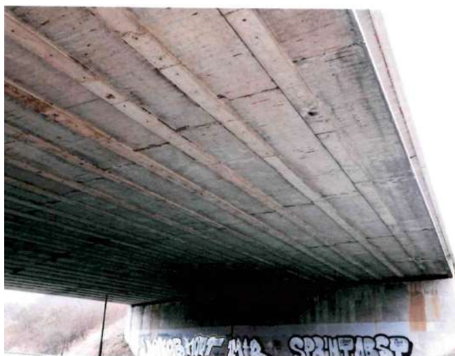
Obrázek 38: Na krajních nosnících stopy po zatékání [2]
