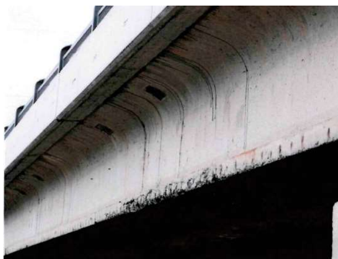
Obrázek 39: Detail korodující výztuže krajního nosníku IS-73, odpadaná betonová krycí vrstva [2]
