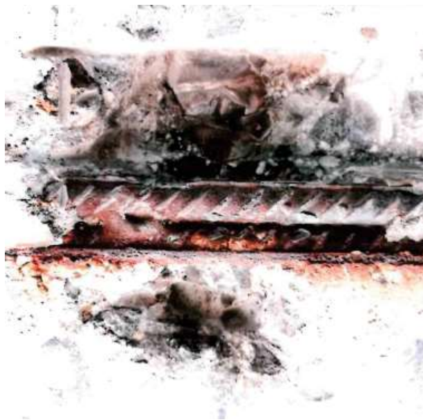
Obrázek 16: Obnažená výztuž nosné konstrukce [2]
