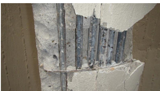
Obrázek 247 Zachycení zcela odpadané krycí vrstvy hlavní výztuže
