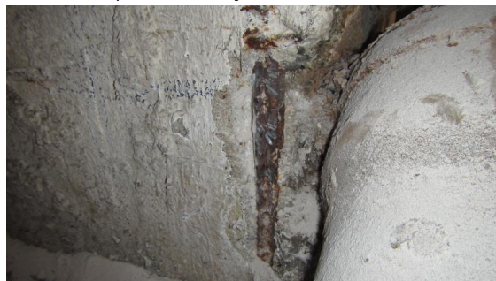
Obrázek 119 Snímek výztuže s krytím 10 mm, u kterého je výraznější povrchová koroze
