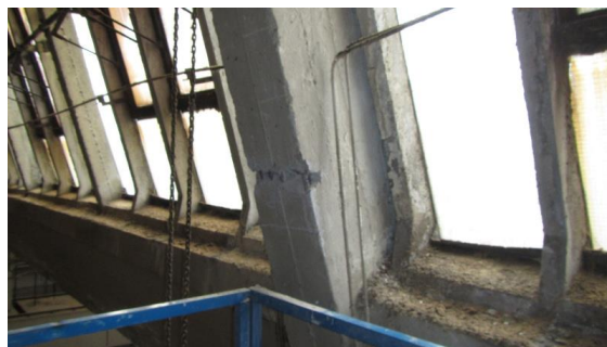
Obrázek 260 Zachycení sekané sondy V - 2 na vzpěře shedové konstrukce nad sloupem K7
