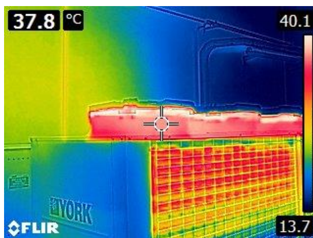
Obrázek 3.2.2 Pohled termokamerou na kompresorovou chladicí jednotku
