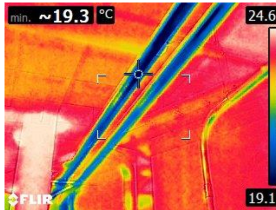
Obrázek 3.1.1 Výstup trubek s chladicí vodou z nádrže
