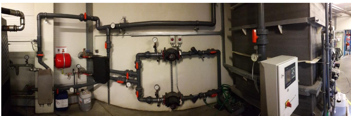
Obrázek 2.1.7 Fotografie zachycující oběhová čerpadla Magna a nádrž na vodu
