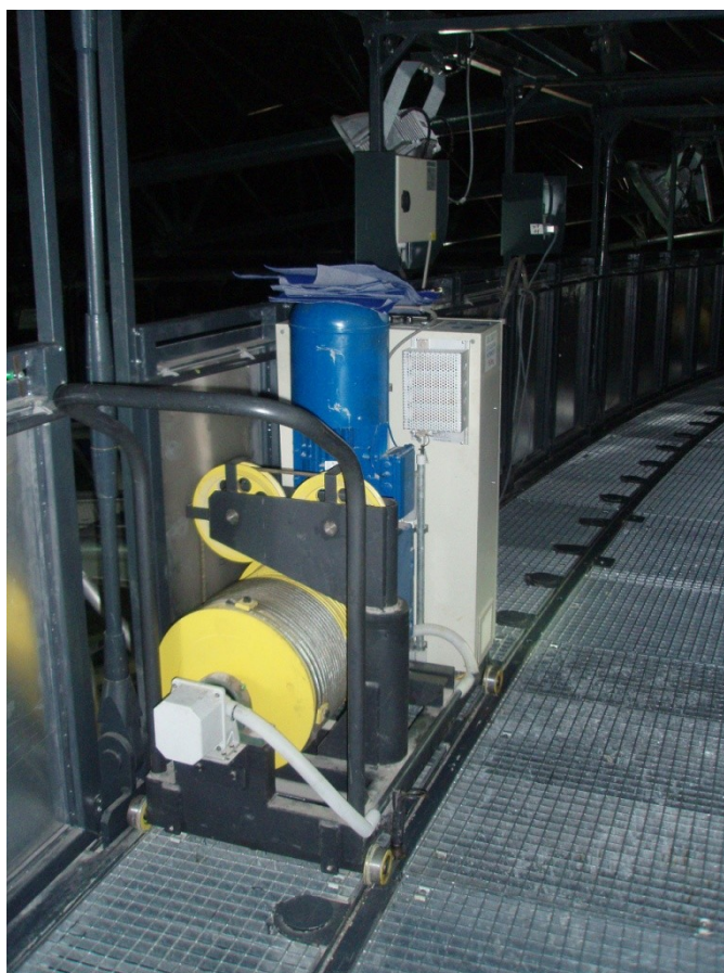
Obr. 24 Naviják GRADIOR s kompenzací pomocí otočného ramene s kladkou v O2 Aréně Praha
