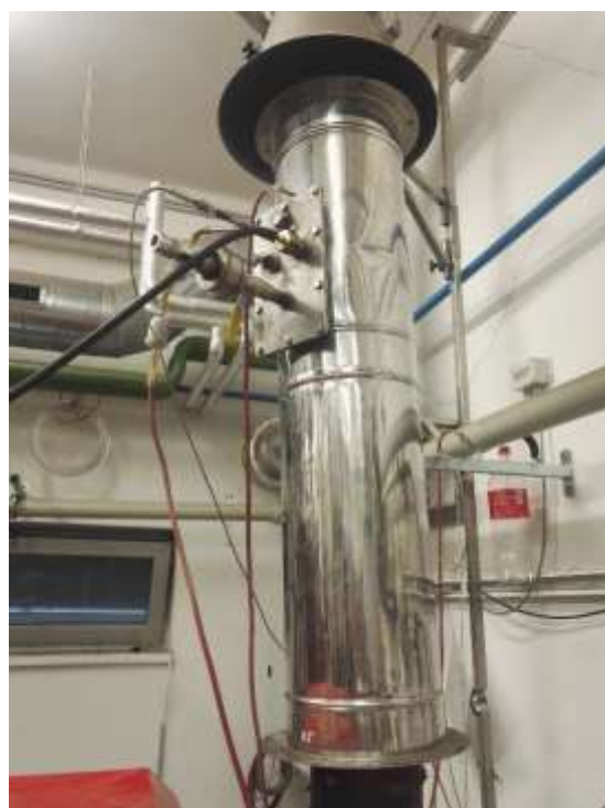
Obr.3.5 Detail zapojení měřících přístrojů ke kouřovodu.
