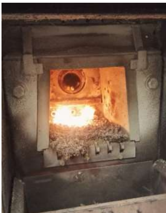
Obr.3.11 Spečené zbytky pelet v kotli
