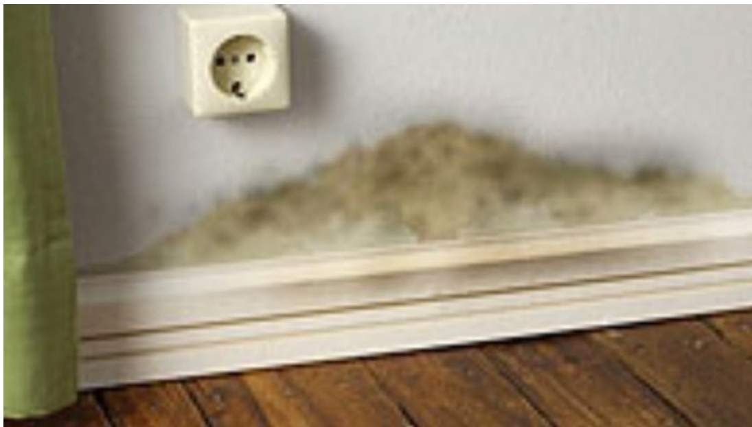
Obr.22 Plíseň na vnitřním povrchu stěny
