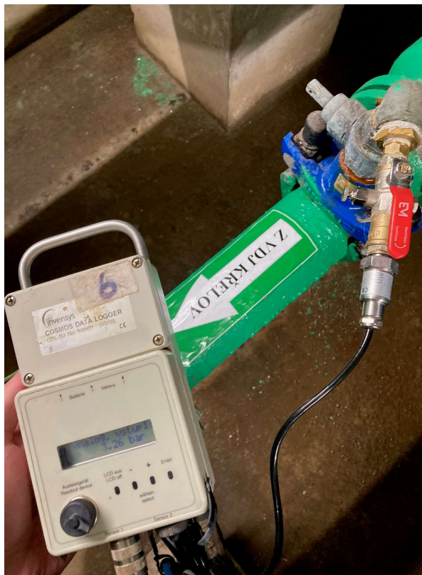
Obrázek č. 17: Napojení dataloggeru na potrubí
