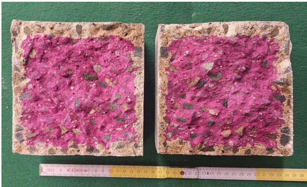
Obr. 40 Hloubka karbonatace po 90 dnech v karb. komoře – beton 0/2
