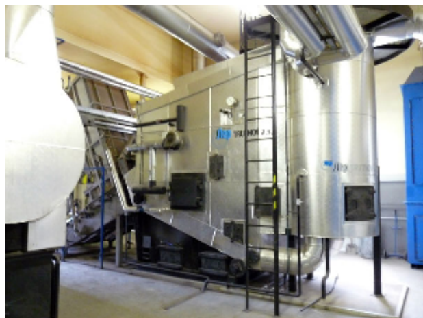
Obr. 14 Kotel na spalování biomasy [46]
