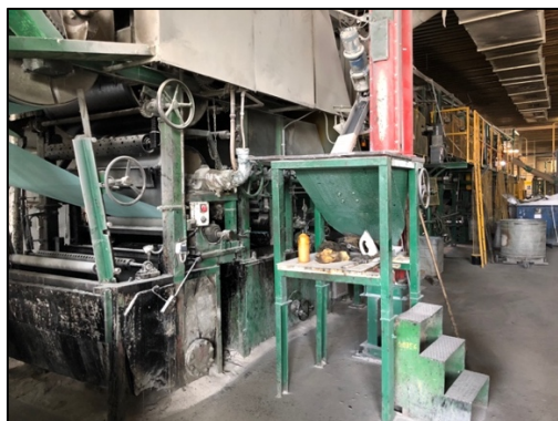
Obr. č. 11: Výrobní linky pro výrobu asfaltových pásů – vana pro nanášení asfaltové povlakové vrstvy s nanášecími válci
