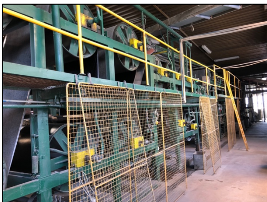
Obr. č. 14: Soustava chladicích válců výrobní linky pro výrobu asfaltových pásů
