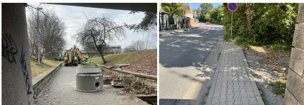
Obr. 24. Neočekávané stavební práce s nechráněným výkopem a neočekávaně končící chodník bez vodicí linie a přechodu pro chodce
