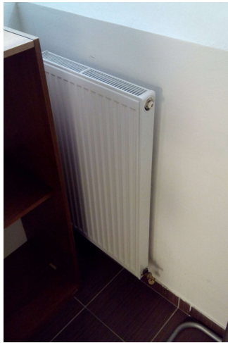
Obrázek 26 Otopné těleso v objektu
