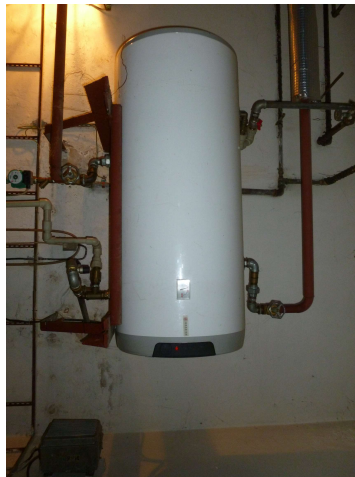
Obrázek 27 Ohřívač teplé vody v 1PP
