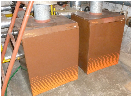
Obrázek 24 Plynové kotle v IPP
