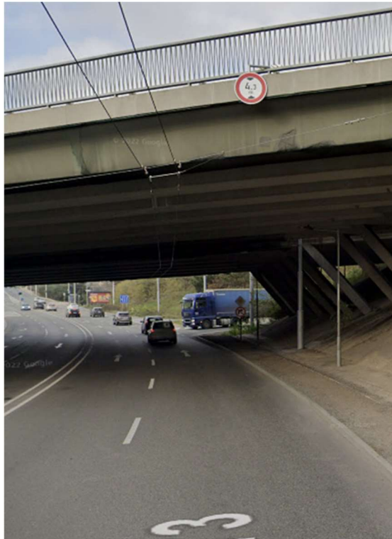
Obrázek 63 – Podjezd na ulici Řípská [2]
