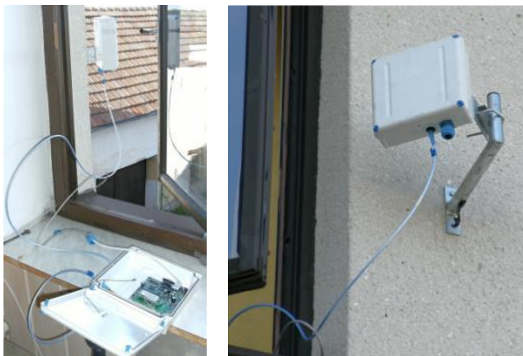
Obr. 103 Vnitřní (vlevo) a venkovní (vpravo) pohled na instalovanou anténní řadu 2x2 s boxem
