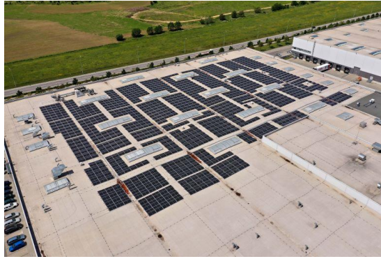
Obrázek č. 9: Solární elektrárna na střeše brněnské pobočky (Zdroj: Researchjobs, © 2023)
