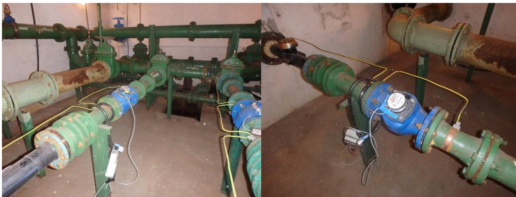
Obr. 4.5 Měření průtoku ve VDJ Hvozdná – čidlo REED a připojený datalogger
