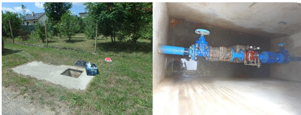
Obr. 4.4 Armaturní šachta s regulačním ventilem CLA VAL DN 50
