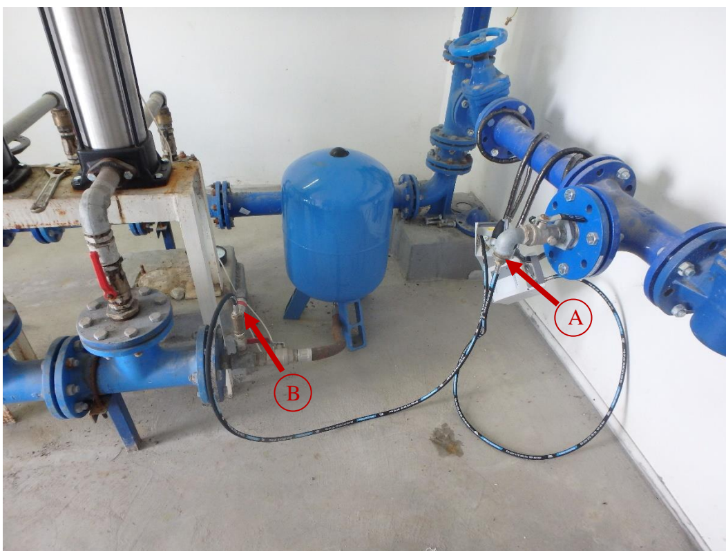
Obr. 4.6 Měření tlaků v ATS Hvozdná – na konci příváděcího řadu z VDJ Hvozdná (A) a na výtlaku za čerpadly do tlakového pásma T1 (B)
