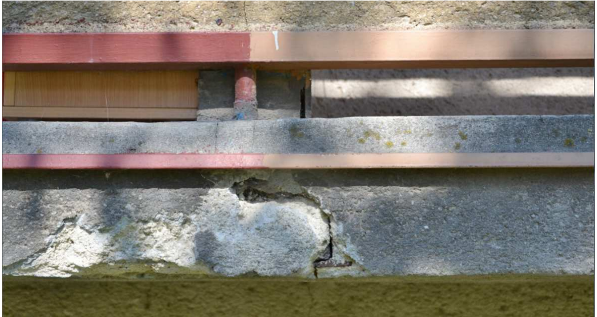
Obr. 14: Detail excentricky uložené dělicí stěny na prefabrikovaných balkonech. Tíha stěny působí na uložení PZ desek a způsobuje lokální poruchu (viz Obr. 14).
