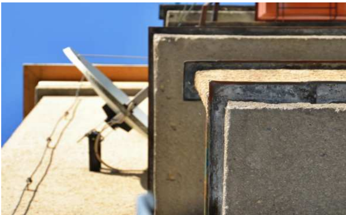
Obr. 11: Pohled zespodu na přečnávající balkon ve 3 NP.
