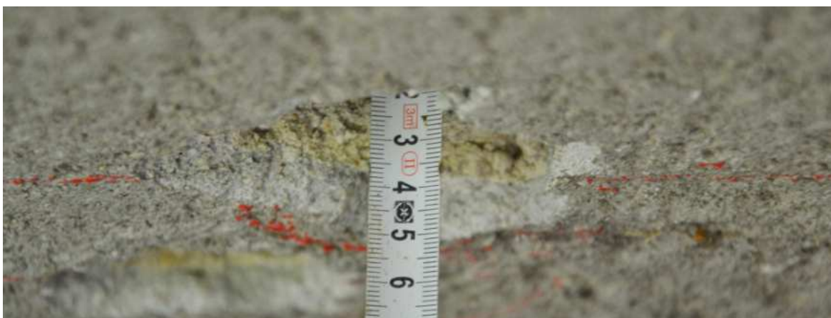
Obr. 28: Měření krytí hlavní výztuže v sekané sondě „D“ (viz příloha 4). Po odečtení omítky bylo krytí stanoveno na pouhých 25 mm.
