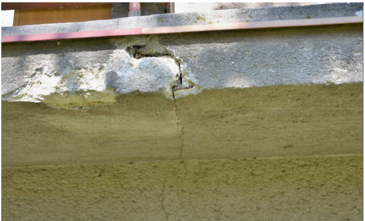
Obr. 15: Lokální trhlinka způsobena excentrickým uložením dělicí stěny vůči prostřednímu ocelovému „I“ profilu.
