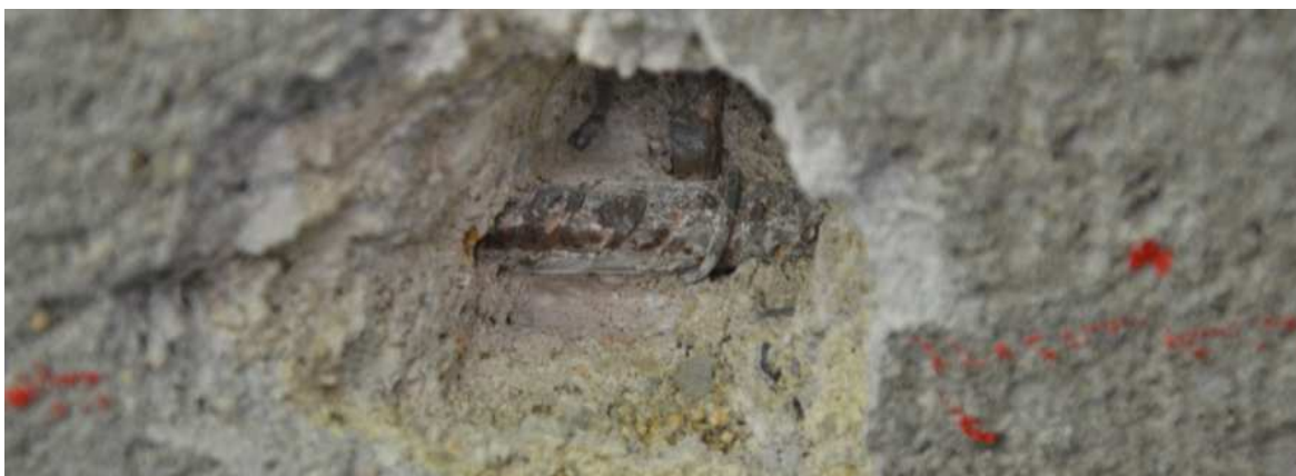
Obr. 27: Detail cílené sekané sondy k hlavní výztuži v místě křížení s výztuží rozdělovací. Jedná se o sondu s označením „D“ (viz příloha 4). V obou případech se jedná o žebírkovou výztuž typu „V“. (hlavní výztuž - Ø 12 mm, rozdělovací Ø 6 mm).
