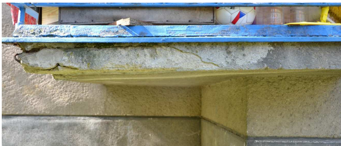
Obr. 17: Balkon v 1.NP – lze zde pozorovat značný průhyb nosné konstrukce.
