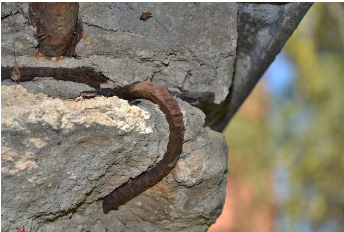
Obr. 18: Detail koroze výztuže a uchycení zábradlí na rohu balkonu v 1. NP
