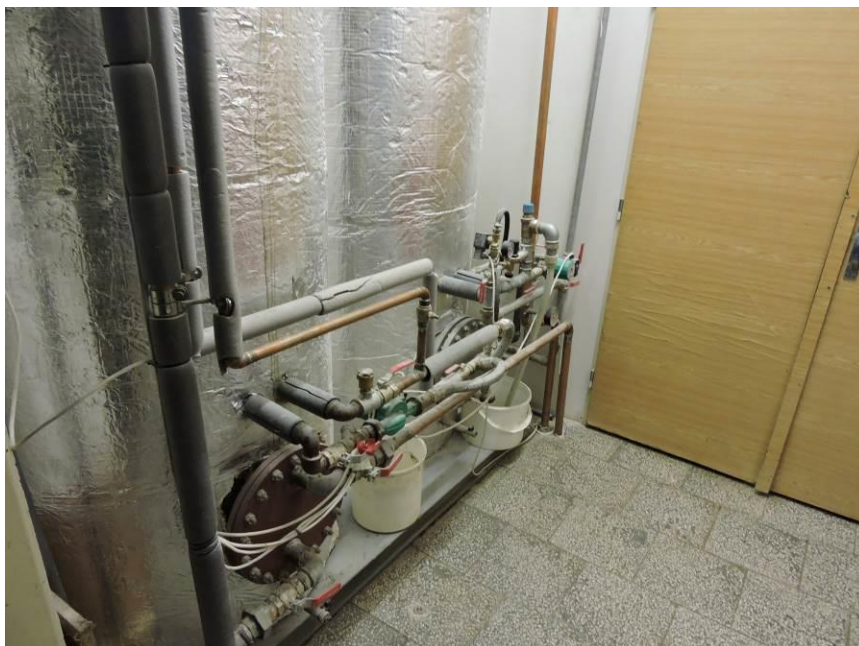
Obr. 21 Nevhodné umístění zásobníků TUV na chodbě
