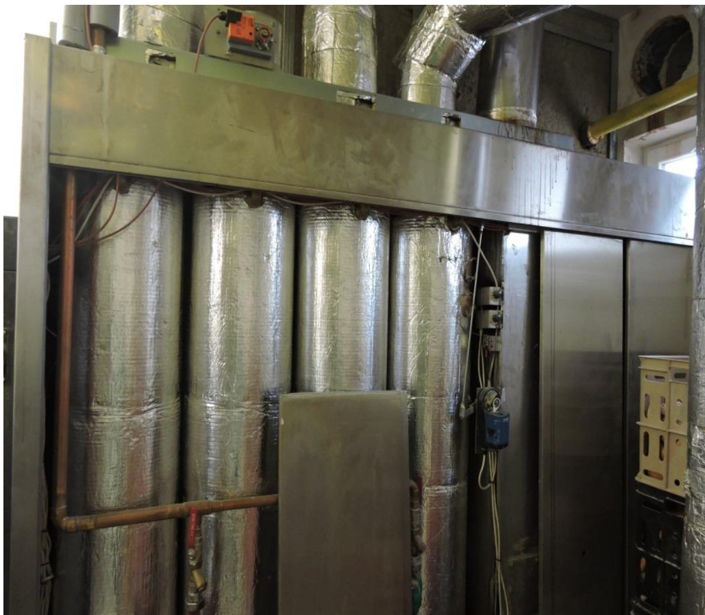
Obr. 20 Zařízení na zpracování odpadního tepla Ekoblok
