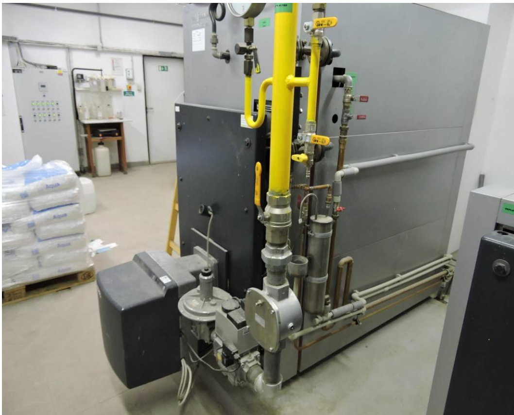
Obr. 26 Parní plynový kotel Viessmann
