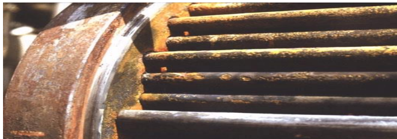
Obr. 12 Koroze na trubkovnici výměníku [13]
