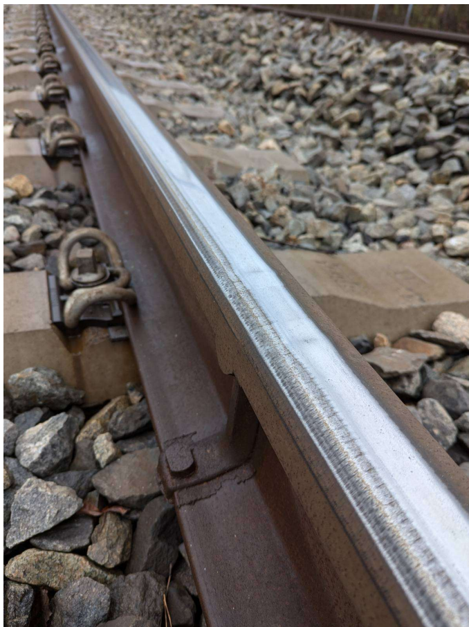
Obrázek 20: Fotka svaru pravé (vnitřní) kolejnice v km 168,414 020 [autor]
