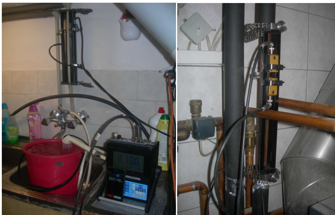
Obrázek 67: Ověřování správné funkčnosti ultrazvukového průtokoměru (vlevo) a instalace na potrubí v měřeně (vpravo)
