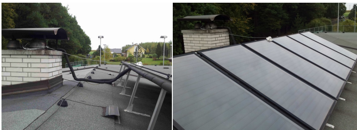
Obrázek 66: Umístění pyranometru na solárních kolektorech
