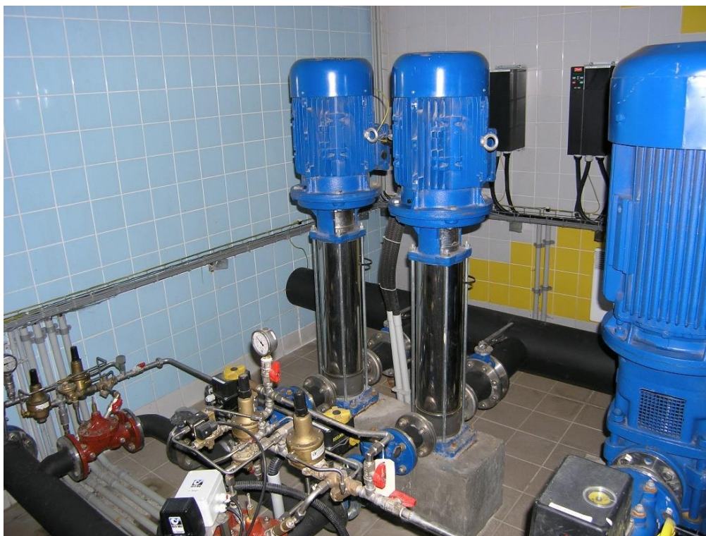
Obrázek 5.4: Čerpadla na ČS Říčka s protirázovou ochranou
