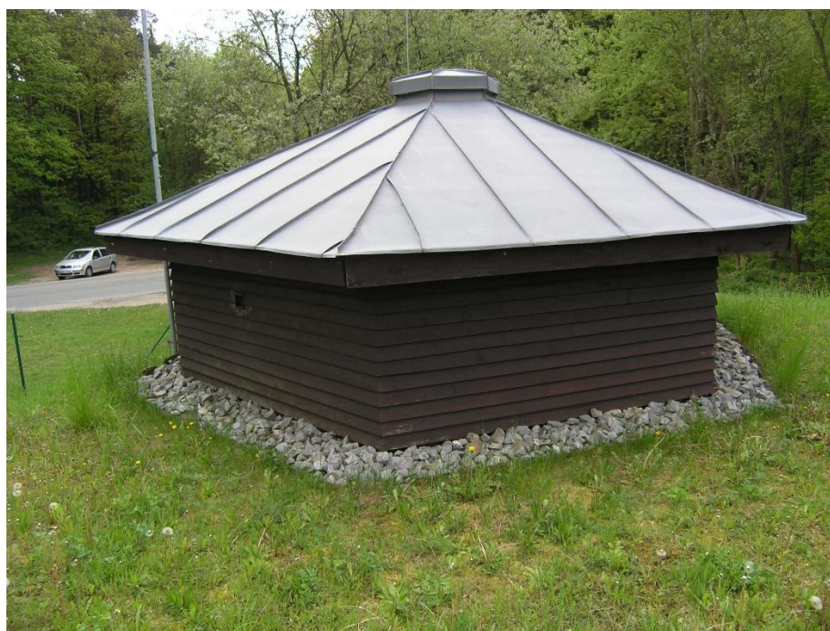
Obrázek 5.13: VDJ Ochoz – stav střechy a vnějších stěn
