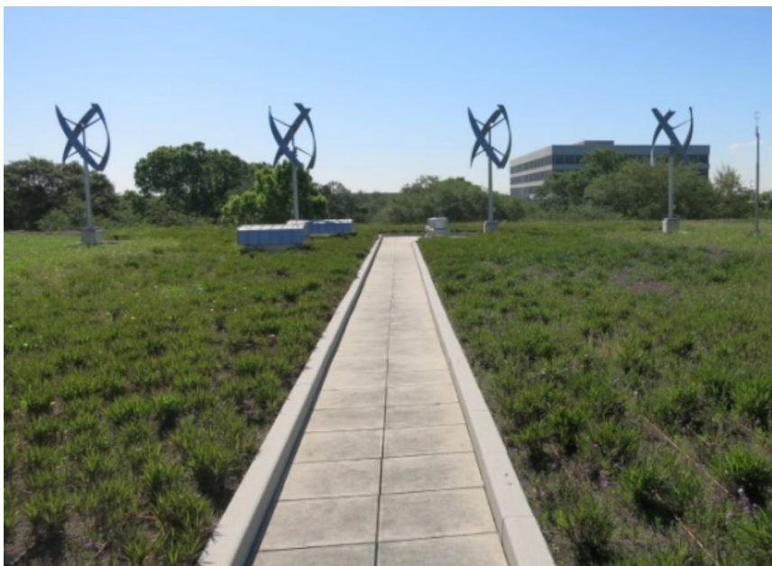
Obrázek 4.6 Turbíny na střeše NASA Building 12 [36]
