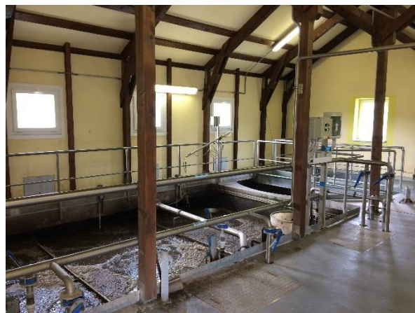
Obr. 6.2-14 ČOV D - Nitrifikační a dosazovací nádrže
