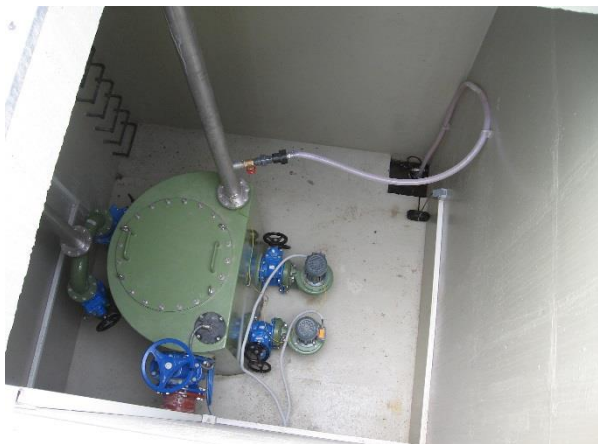
Obr. 6.2-3 ČOV A - Suchá ČS na přítoku
