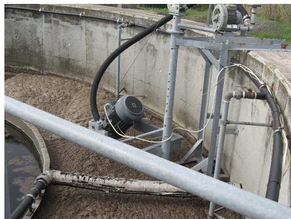
Obr. 6.2-8 ČOV B - Provozní zkouška systému Triton
