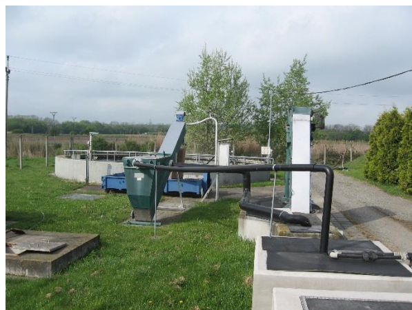
Obr. 6.2-6 ČOV B - Pohled na mechanické předčištění
