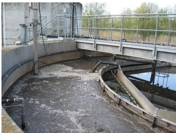
Obr. 6.2-11 ČOV C - Část biologické linky
