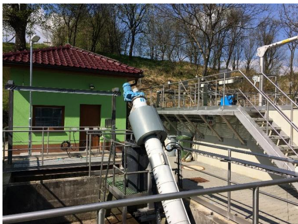
Obr. 6.2-21 ČOV F - Pohled na čistírnu
