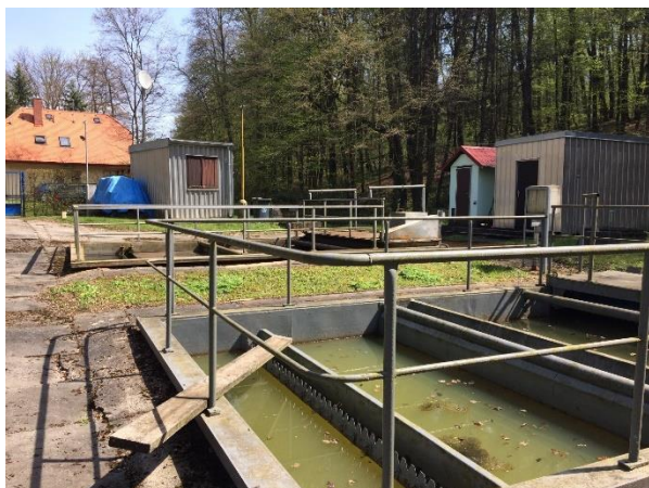
Obr. 6.2-17 ČOV E - Pohled na čistírnu
