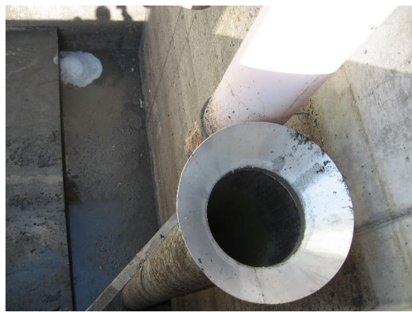
Obr. 6.2-12 ČOV C - Bezpečnostní přeliv dešťové nádrže
