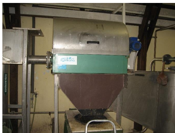
Obr. 6.2-16 ČOV D - Válcové síto na shrabky
