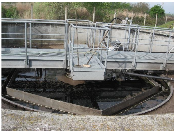
Obr. 6.2-7 ČOV B - Vestavěná dozovací nádrž
