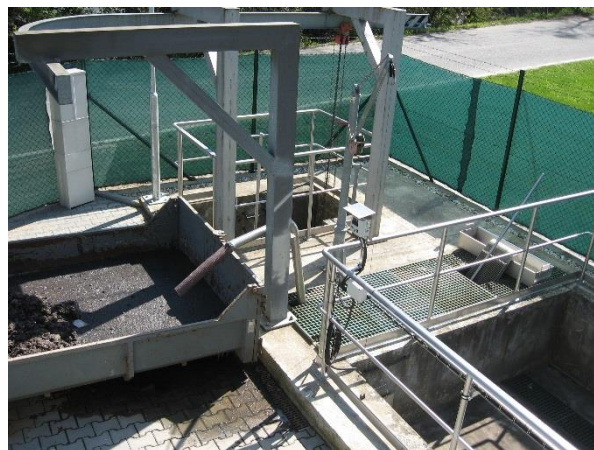
Obr. 6.2-22 ČOV F - Přítok na čistírnu
