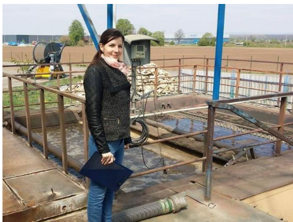
Obr. 6.2-27 ČOV G - Pohled na nádrž se systémem Kessener v pozadí
