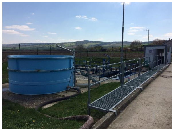
Obr. 6.2-29 ČOV H - Pohled na čistírnu
