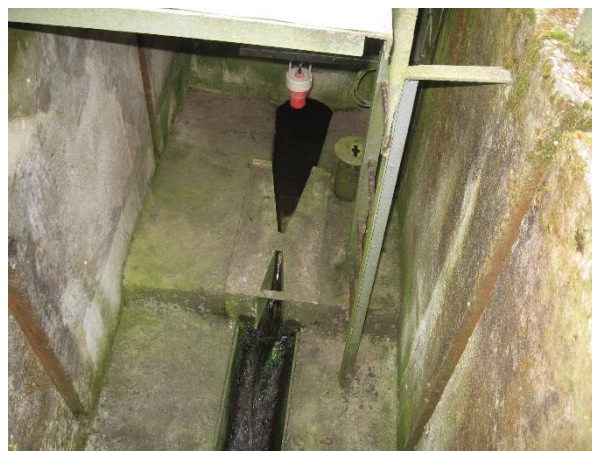
Obr. 6.2-20 ČOV E - Odtok z čistírny přes Parshallův žlab
