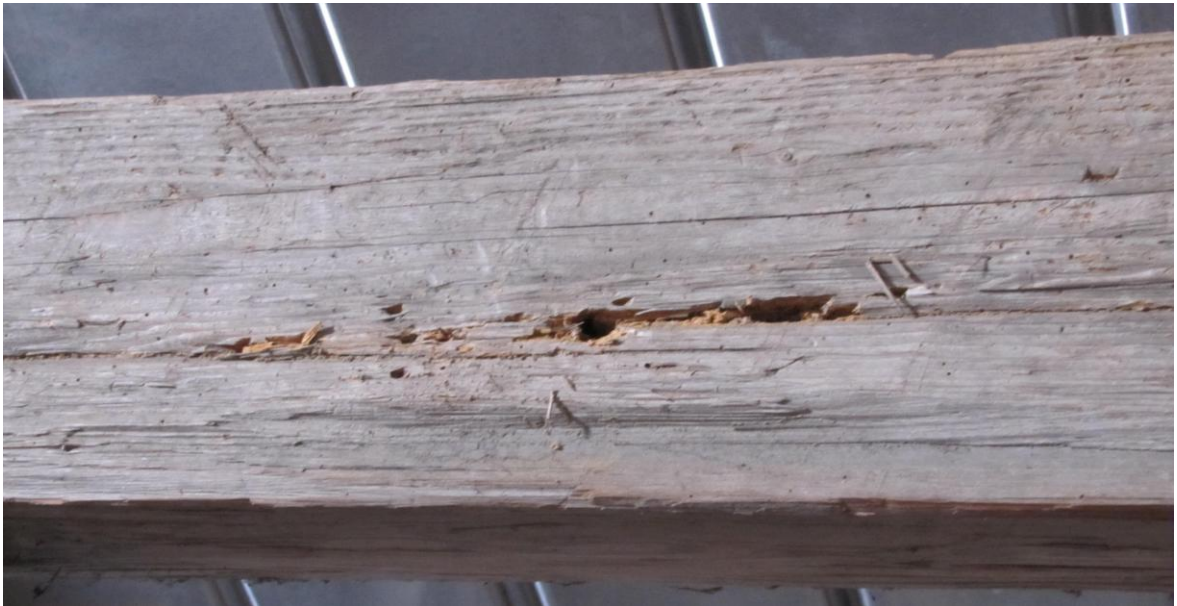
Obr. 5.47: Vaznice napadená červotočem a shnilá v podélné trhlině
