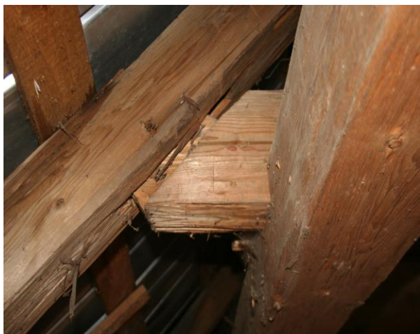
Obr. 5.18: Chybějící kolík, vysunutí
