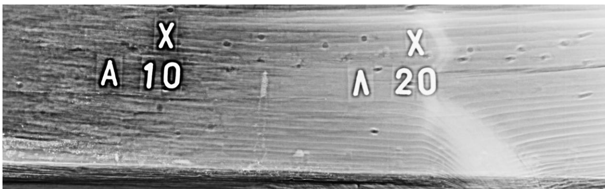
Obr. 5.50: Radiogram fragmentu hambálku. Lze rozeznat markantní rozdíl ve struktuře materiálu v levé části radiogramu s masivní hnilobou, naproti tomu v pravé části radiogramu je možno pozorovat zdravou strukturu dřeva. Radiogram vytvořen rentgenem EcoRay HF1040 s užitím bezdrátového zobrazovacího panelu Aero DR.
