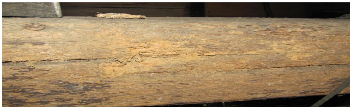
Obr. 5.35: Rozpad vazného trámu v důsledku působení červotoče
