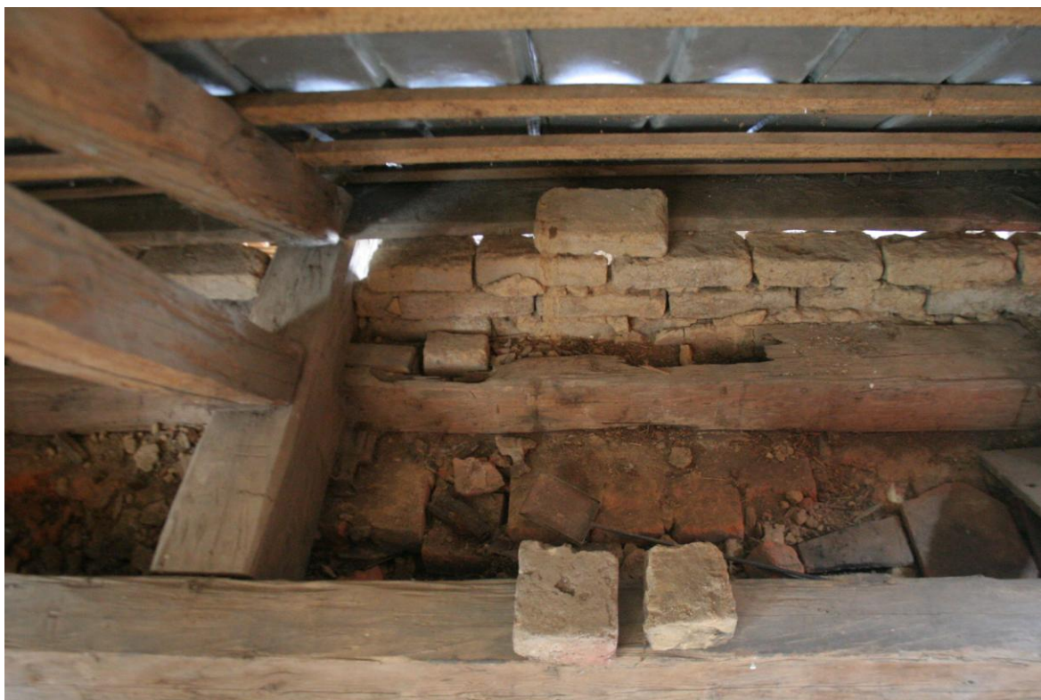
Obr. 5.48: Zničená pozednice povětrnostními vlivy na pravé straně krovu mezi příčnými vazbami 2 a 3. Na fotografii také vidíme výměnu krácat, kráče, krokev a námětek.
