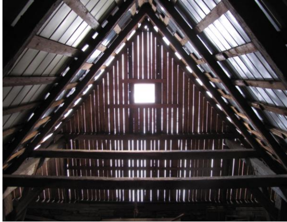
Obr. 5.6: : Pohled na konstrukci krovu (severní strana). První a třetí vazba plná, druhá vazba prázdná
