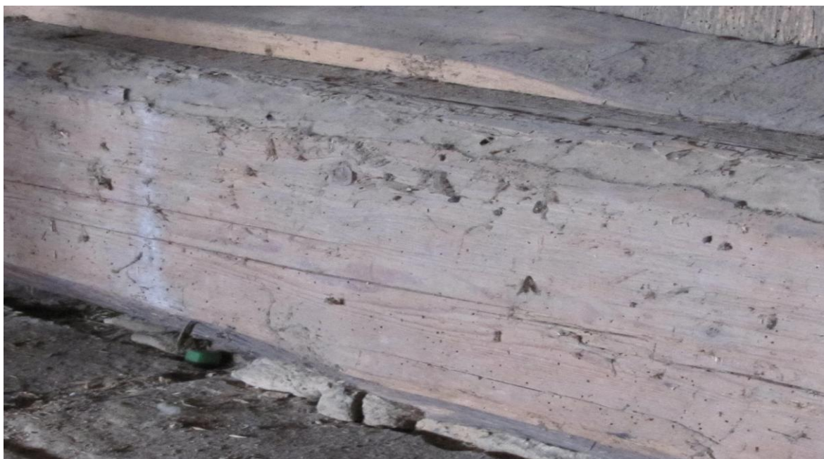
Obr. 5.25: Vazný trám – výletové otvory od červotoče
