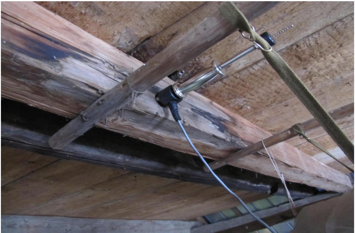
Obr. 5.49: Měření vlhkosti hambálku 3. příčné vazby v místě, kde zatékala voda. Naměřená vlhkost 13,3 % - dřevo je již vysušené.
