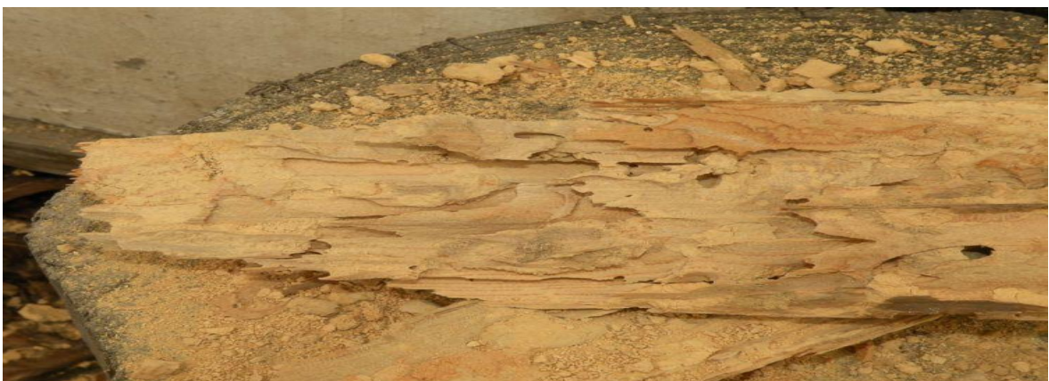
Obr. 3.12: Zničené dřevo od Tesaříka krovového, autor fotografie: Václav Hanzlík ze dne 23. únor 2010 [22]
