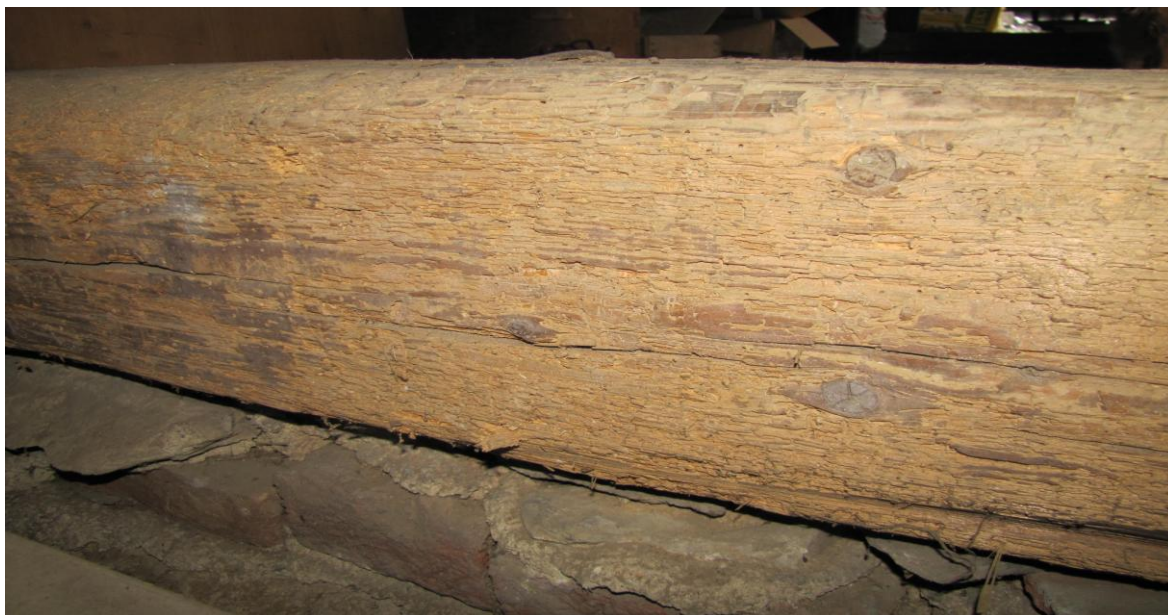
Obr. 5.30: Odkryté chodbičky a výletové otvory od červotoče ve vazném trámu
