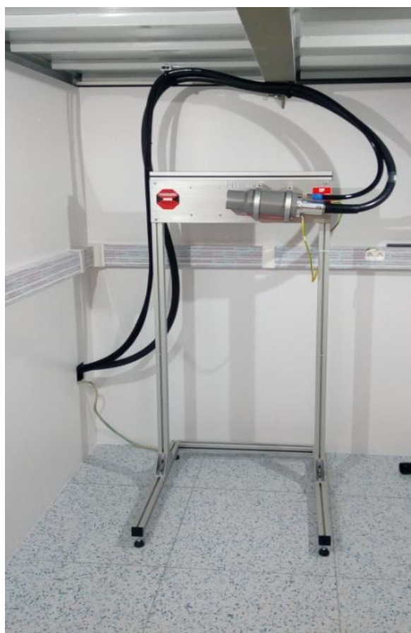
Obr. 15: Vyvedená kabeláž k rentgence, umístěné na provizorním stojanu [36]
