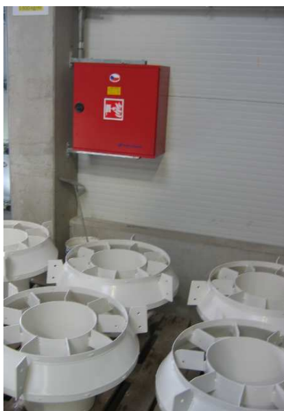
Obr. 32 Zatarasená cesta k hasicímu zařízení.
