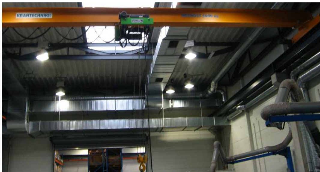
Obr. 39 Mostový jeřáb nad pracovištěm.
