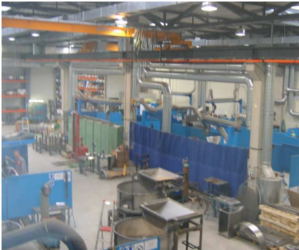
Obr. 29 Pohled na odsávací systém nad svařovnou.
