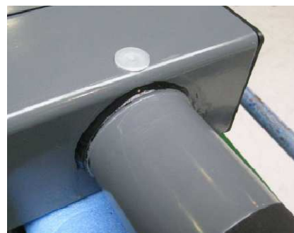
Obr. 48 Zatmelená spára kolem vodící tyče
