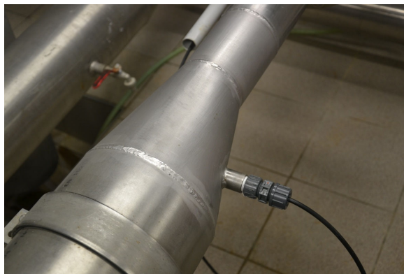
Obrázek 7.7 Zaústění chlornanu sodného
