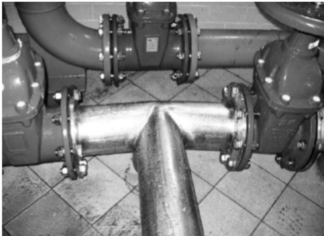
Obrázek 4.7 Nadměrná deformace- důsledek poddajnosti tenkostěnné trubky při běžném přetlaku [18]
