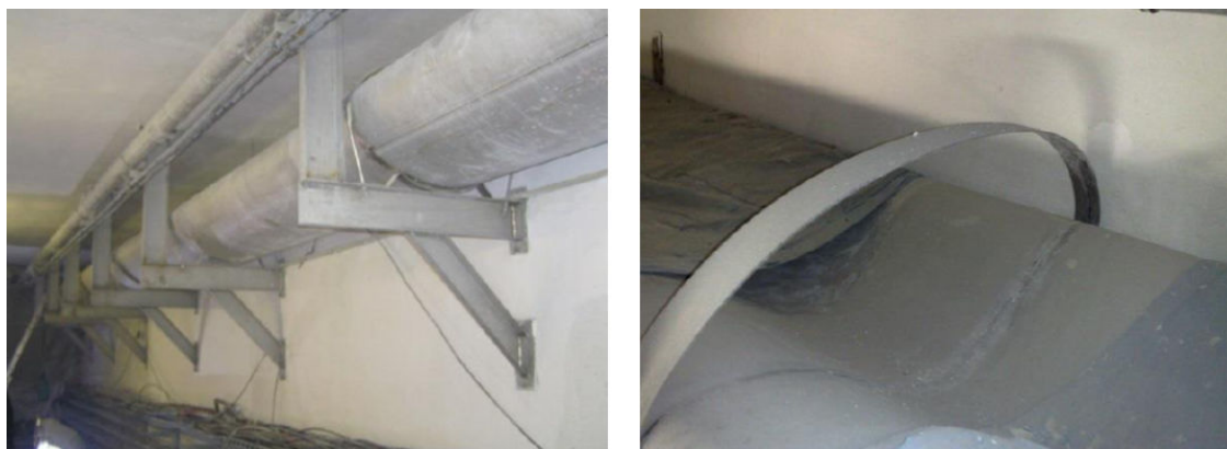
Obrázek 4.6 Ztráta stability tvaru-nerez potrubí-důsledek podtlaku při hydraulickém rázu [18]
