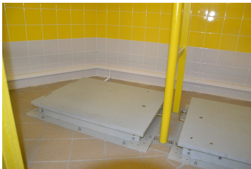
Obrázek 7.17 Vstup do akumulční komory VDJ Ochoz u Brna
