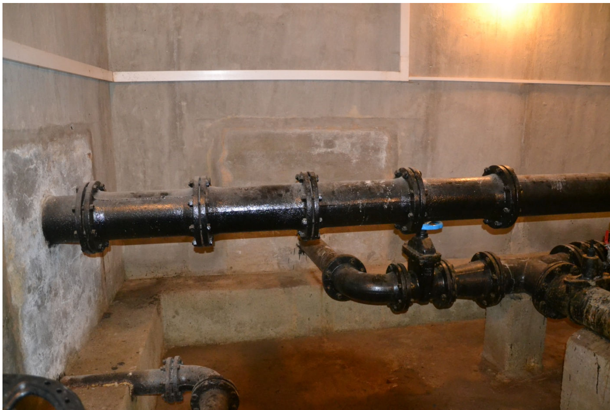
Obrázek 7.22 Část litinového potrubí v armaturní komoře
