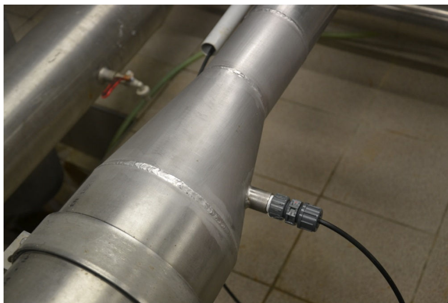
Obrázek 4.9 Dávkování chlornanu sodného do nerezového potrubí-kritické místo z hlediska vzniku koroze
