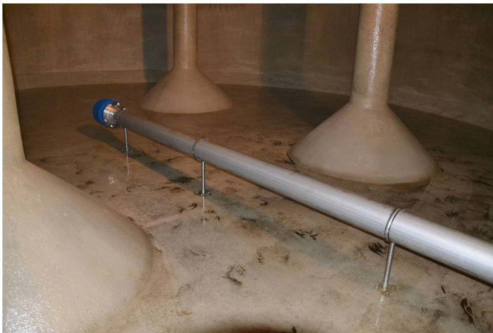
Obrázek 7.27 Odběrné potrubí VDJ Oslavany
