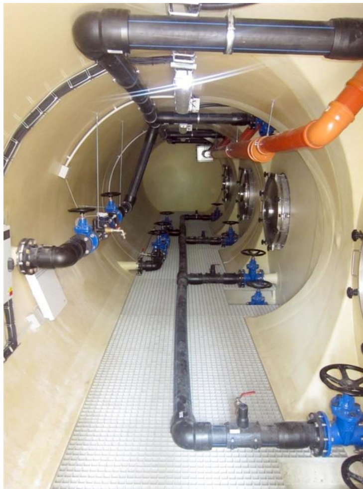
Obrázek 5.5 Armaturní komora VDJ Klepačov[7]
