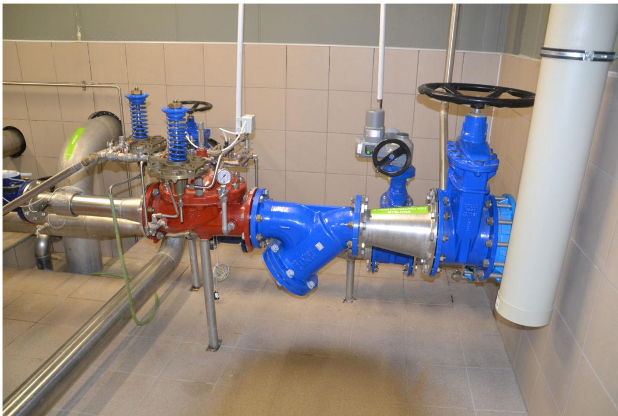
Obrázek 7.8 Část přívodního potrubí
