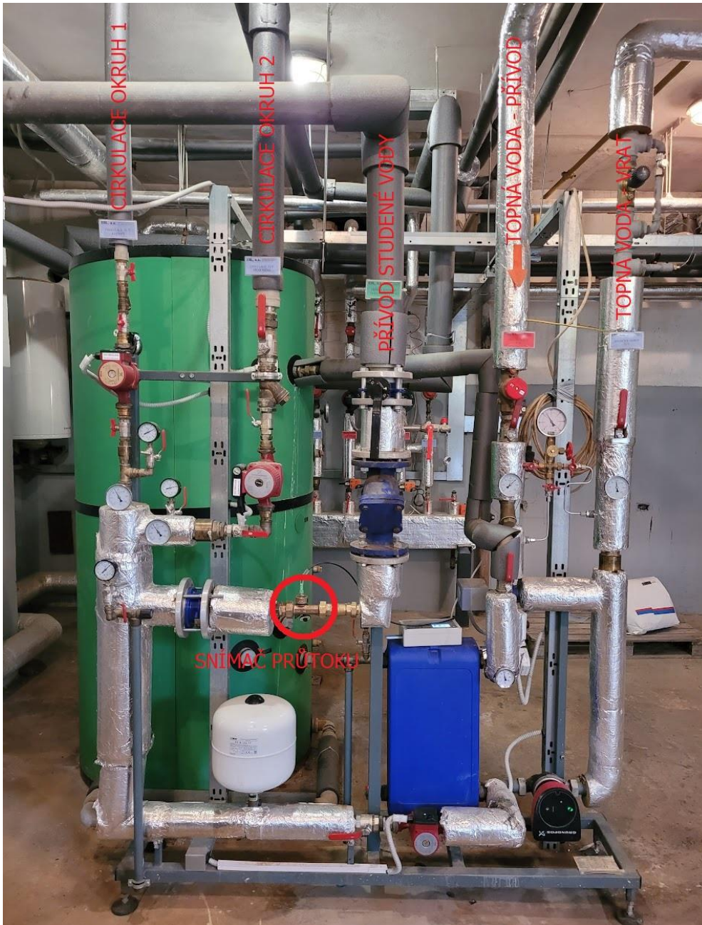
Obrázek 20 příklad zabudování snímače průtoku – další objekt
