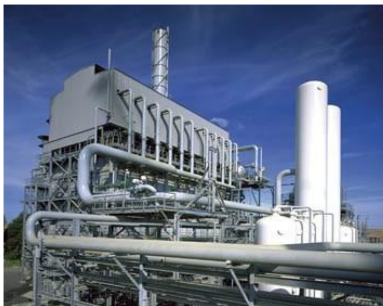
Obr. 4-1: Stanice na parní reformování zemního plynu [32]
