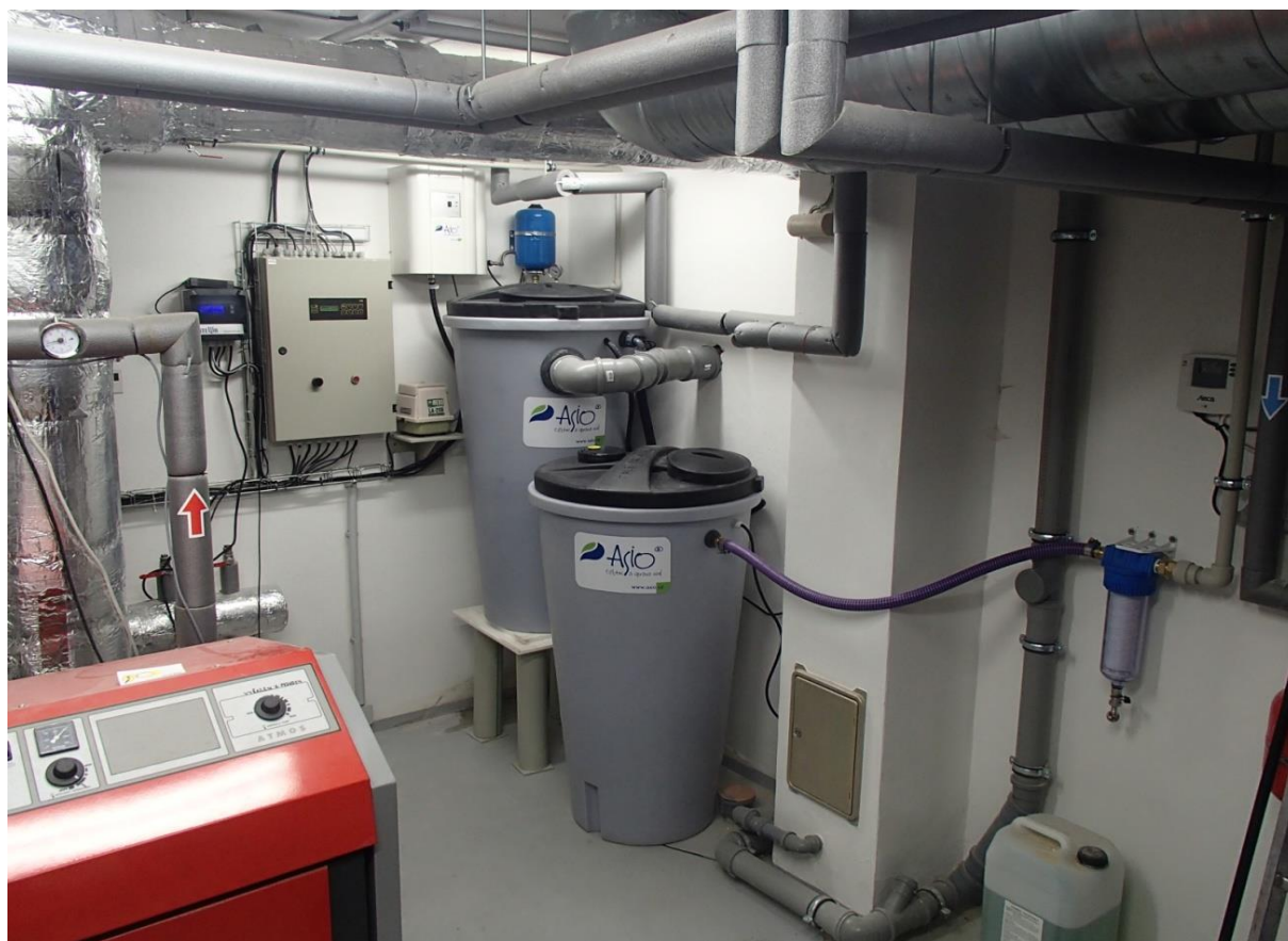
Obrázek 5.2 Čisticí jednotka AQUALOOP firmy Asio v objektu centra Rozmarýnek [82]
