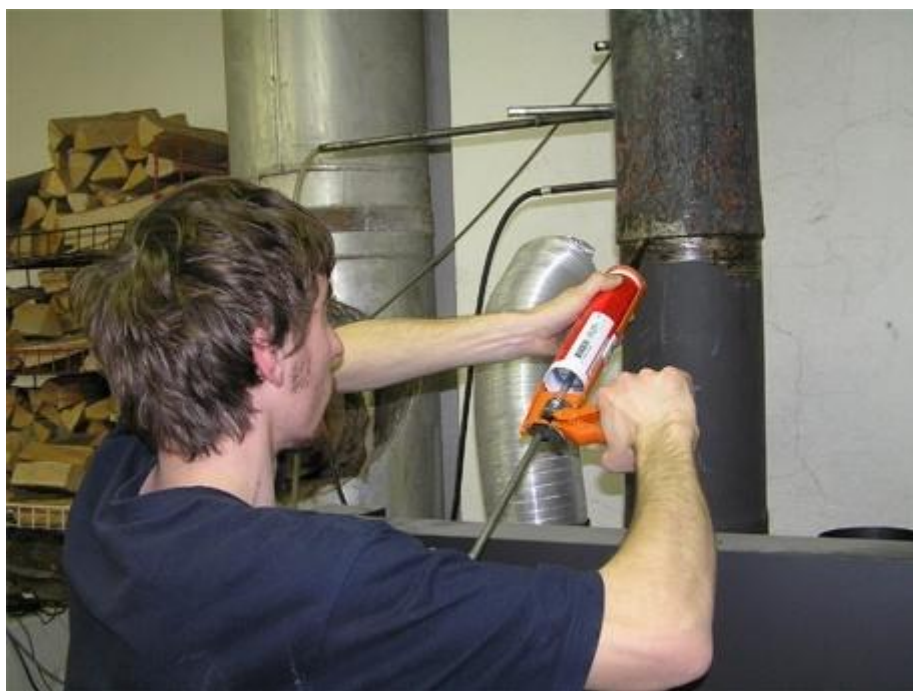
Obr.6 Měřicí úsek spalin a jeho zatěsňování
